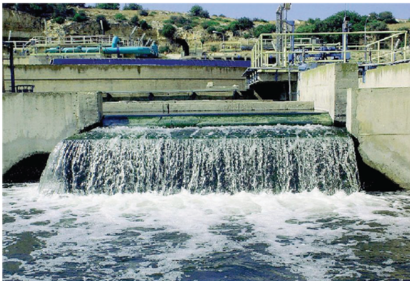
Il depuratore di contrada Canalicchio nell'Agrigentino
